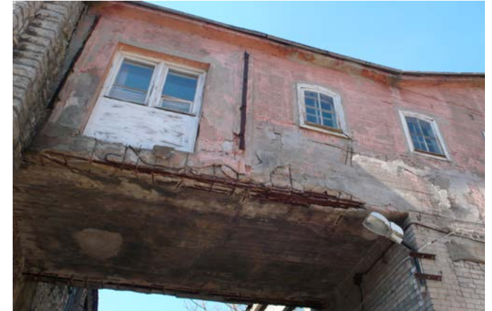
Siin on kahjustused juba tõsised. Foto: M. Mändel
