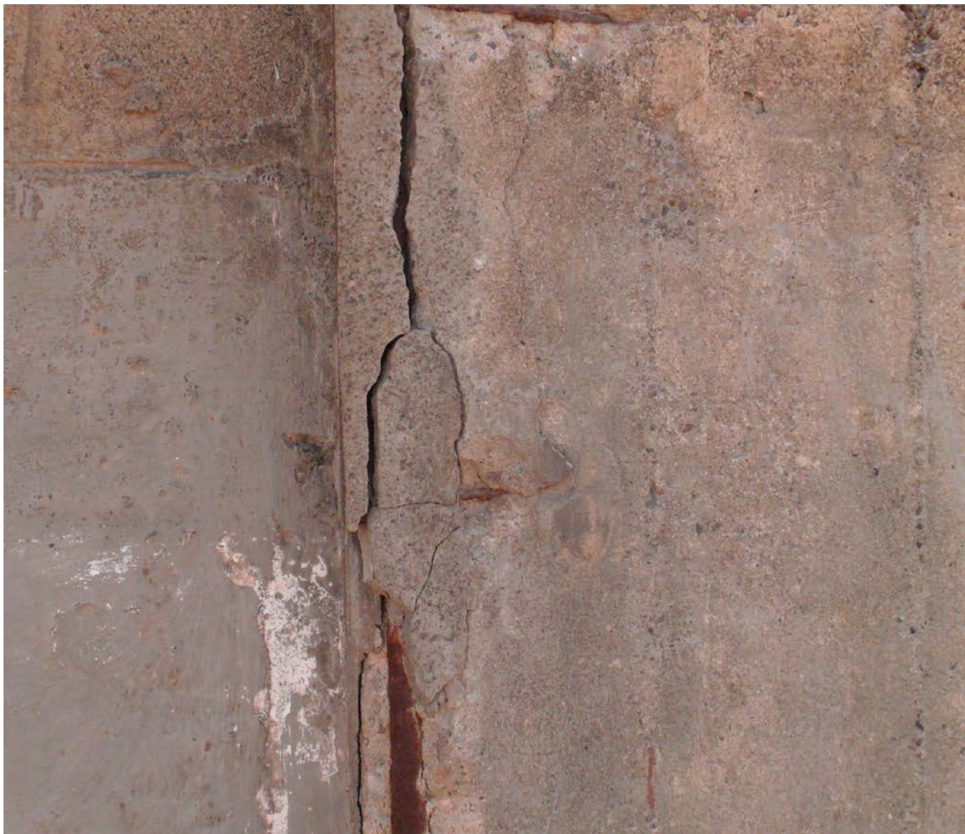
Roostetav sarrus on põhjustanud betoonipinna pragunemise. Foto: M. Mändel
