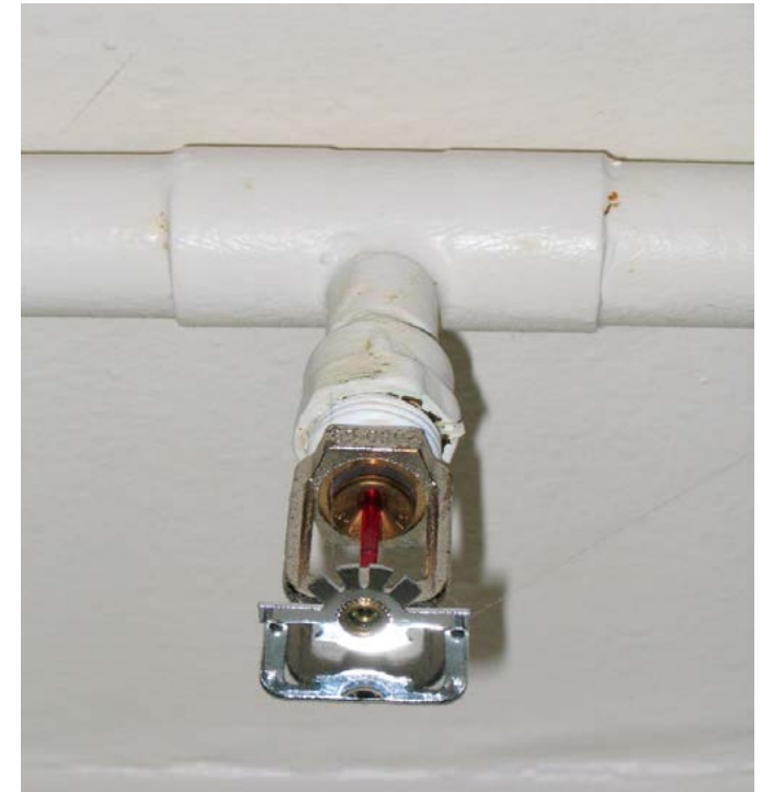
Veeudusprinkler. Foto: J. E. Field
