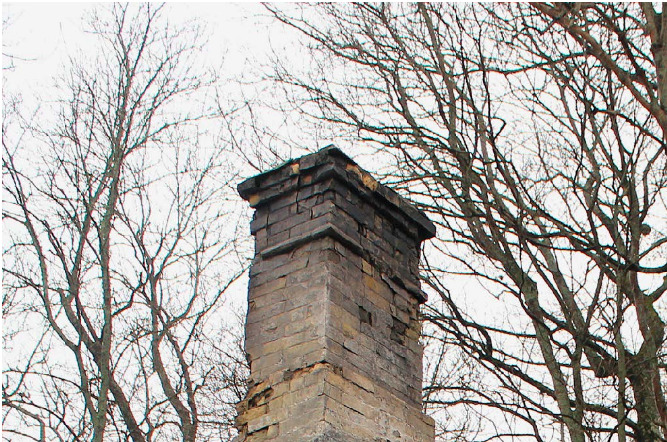
Tuleohtlik korstnapits. Foto: C. Valge
