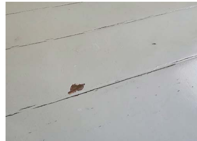
Mehaaniline kahjustus värvitud parkettpõrandal. Foto: C. Valge
